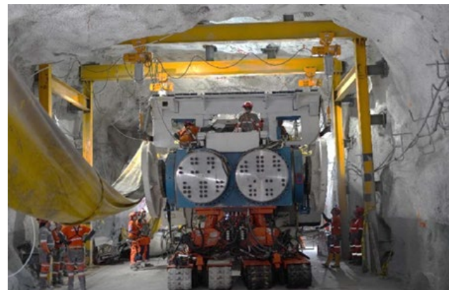
▲ Figura 11. Bastidor principal de la tuneladora MDM sobre orugas de transporte dentro del área de la cámara de montaje.
