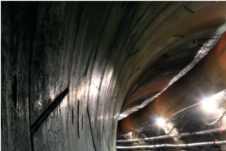
▲ Fotografía 9. TBM de doble escudo usada en el túnel del PH La Joya.
