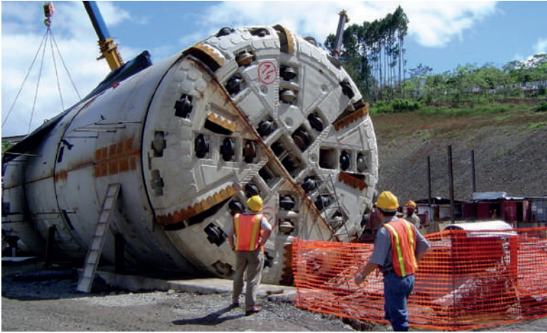
▲ Fotografía 9. TBM de doble escudo usada en el túnel del PH La Joya.
